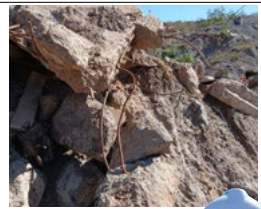
Contenant beaucoup trop de ferraille, ces blocs ne pourront pas être recyclés.
